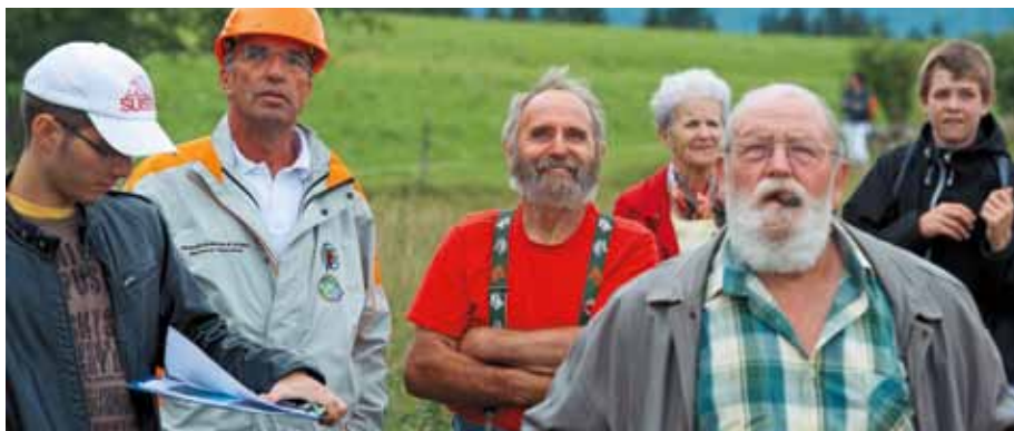
Der Präsident der JUVENT SA, Martin Pfisterer (mit orangem Bauhelm), verfolgt zusammen mit Besucherinnen und Besuchern die Montage der Turbine 12.
